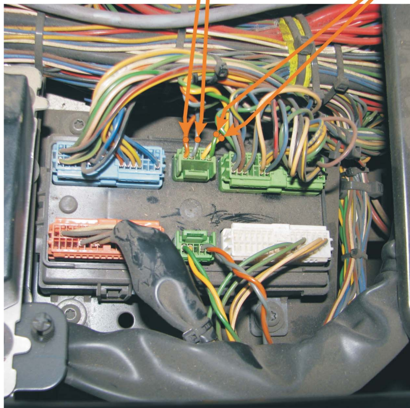
POD SKRZYŃKĄ BEZPIECZNIKÓW UNDER THE FUSE BOX ПОД ПОДУШКОЙ БЕЗОПАСНОСТИ
